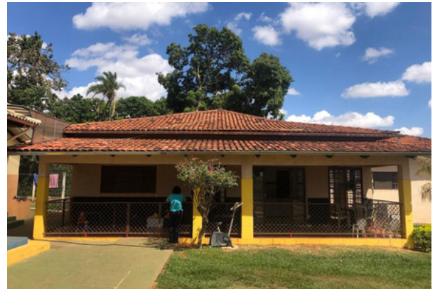
Telhado da casa que precisa reformar
